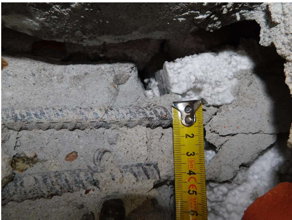
Fot nr 88. Widok odkrywki w nadprożu w wiatrołapie do klatki schodowej nr 7
