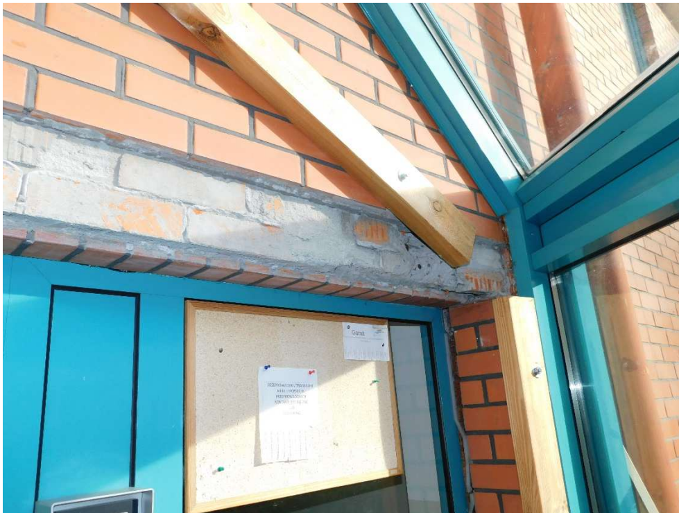
Fot nr 81. Widok uszkodzonego nadproża w wejściu do klatki schodowej nr 7
