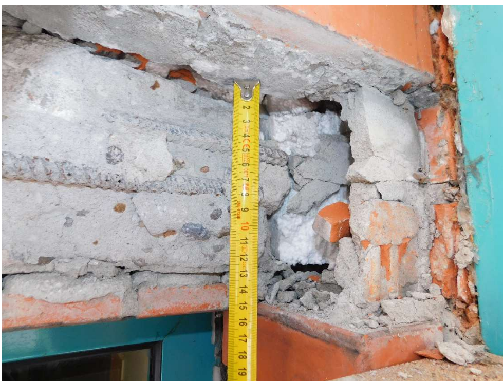
Fot nr 89. Widok odkrywki w nadprożu w wiatrołapie do klatki schodowej nr 7
