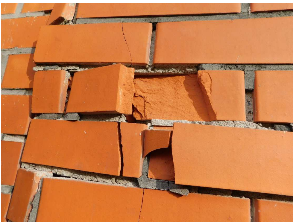
Fot nr 72. Widok destrukcji cegieł klinkierowych
