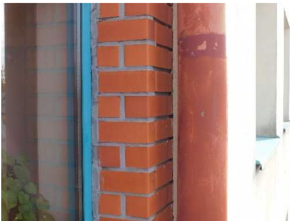
Fot nr 58. Widok uszkodzenia dylatacji okno ściana klinkierowa nad wejściem klatka 7
