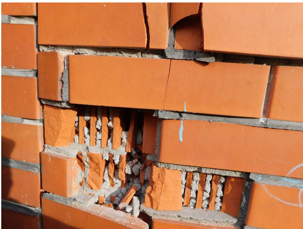
Fot nr 73. Widok destrukcji cegieł klinkierowych
