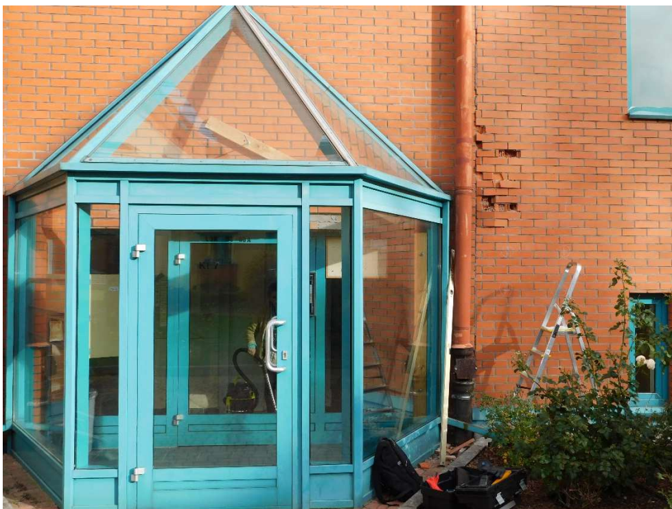
Fot nr 23. Uszkodzenie elewacji przy klatce nr 7
