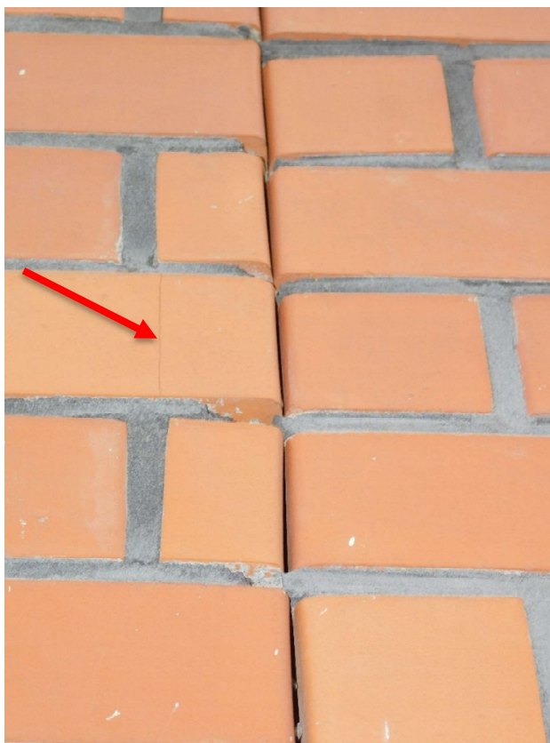
Fot nr 35. Uszkodzenie przy dylatacji pomiędzy klatkami 5 i 6
