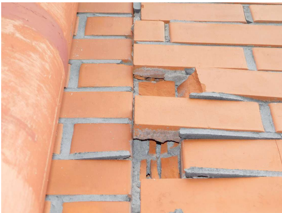
Fot nr 29. Widoczny zbyt mała szerokość dylatacji w miejscu uszkodzenia
