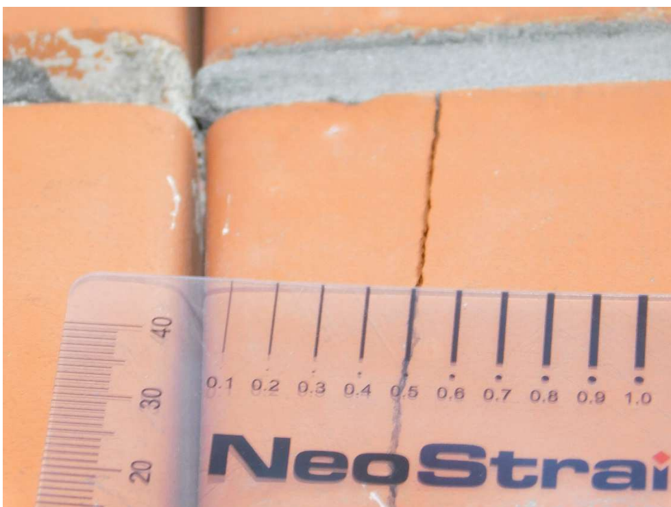
Fot nr 34. Uszkodzenie przy dylatacji pomiędzy klatkami 5 i 6
