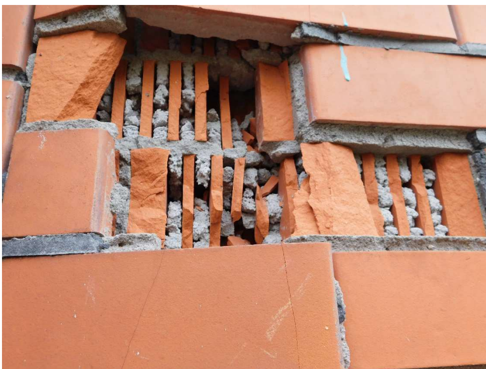
Fot nr 26. Uszkodzenie elewacji przy klatce nr 7
