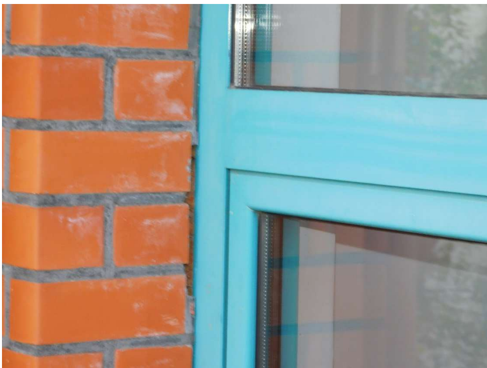
Fot nr 63. Widok ubytków dylatacji okno ściana klinkierowa nad wejściem klatka 1
