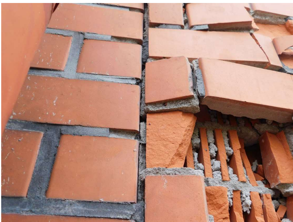
Fot nr 32. Uszkodzenie elewacji przy klatce nr 7
