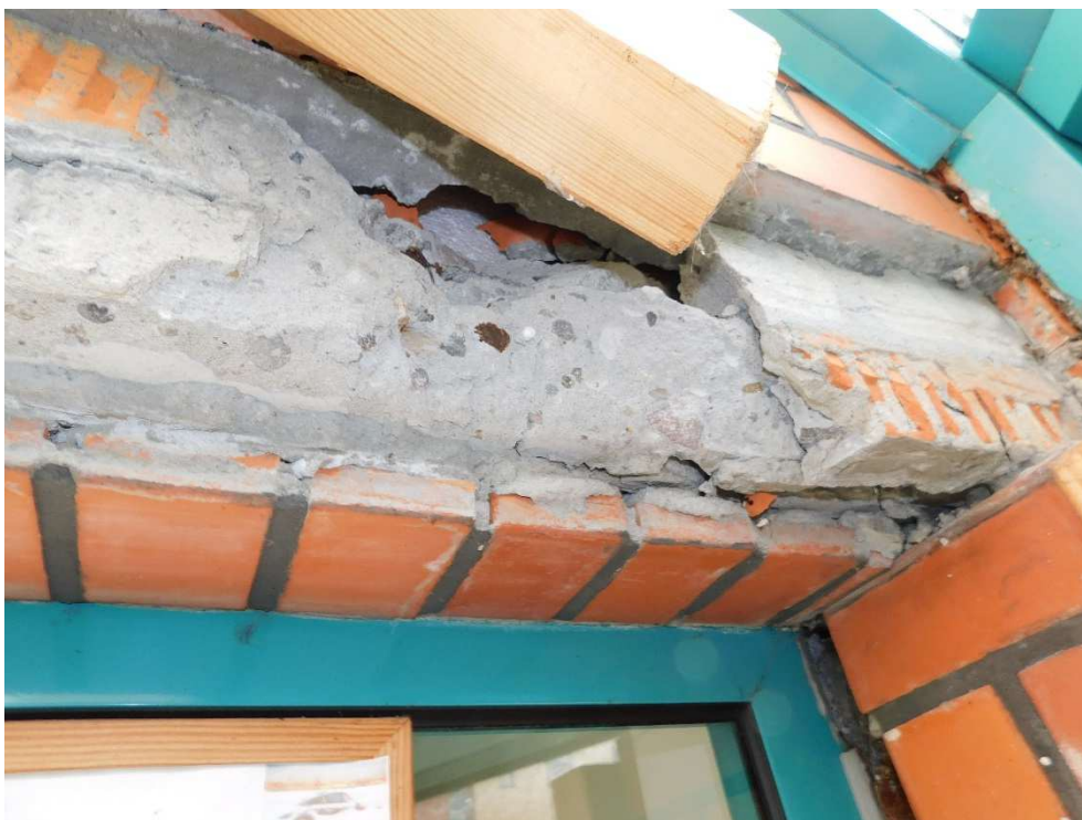
Fot nr 82. Widok uszkodzonego nadproża w wejściu do klatki schodowej nr 7
