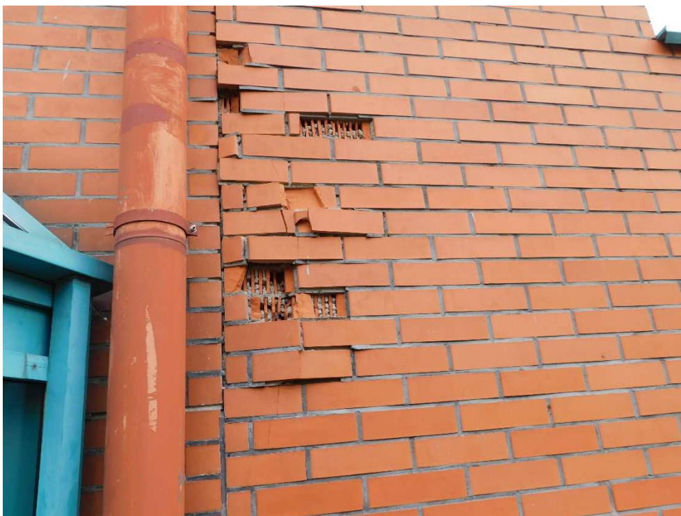
Fot nr 25. Uszkodzenie elewacji przy klatce nr 7
