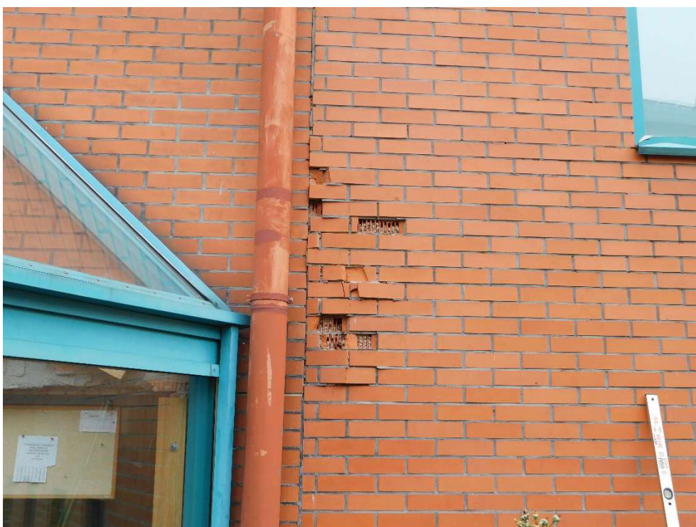
Fot nr 24. Uszkodzenie elewacji przy klatce nr 7
