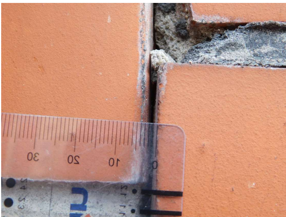
Fot nr 28. Widoczna zbyt mała szerokość dylatacji w miejscu uszkodzenia
