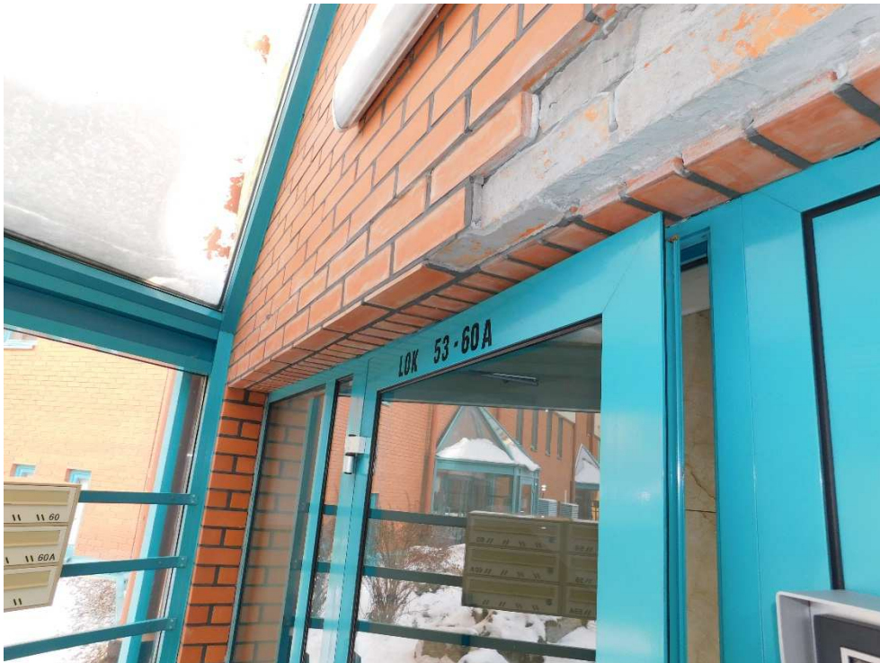
Fot nr 84. Widok uszkodzonego nadproża w wejściu do klatki schodowej nr 7
