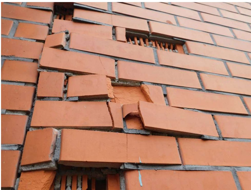
Fot nr 27. Uszkodzenie elewacji przy klatce nr 7
