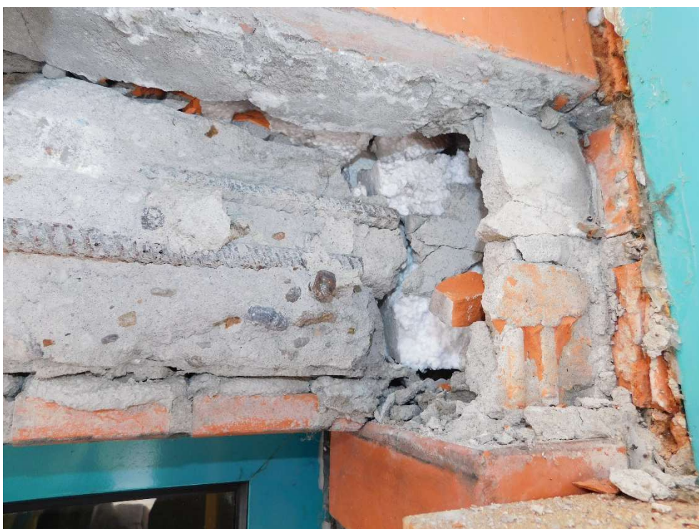
Fot nr 87. Widok odkrywki w nadprożu w wiatrołapie do klatki schodowej nr 7
