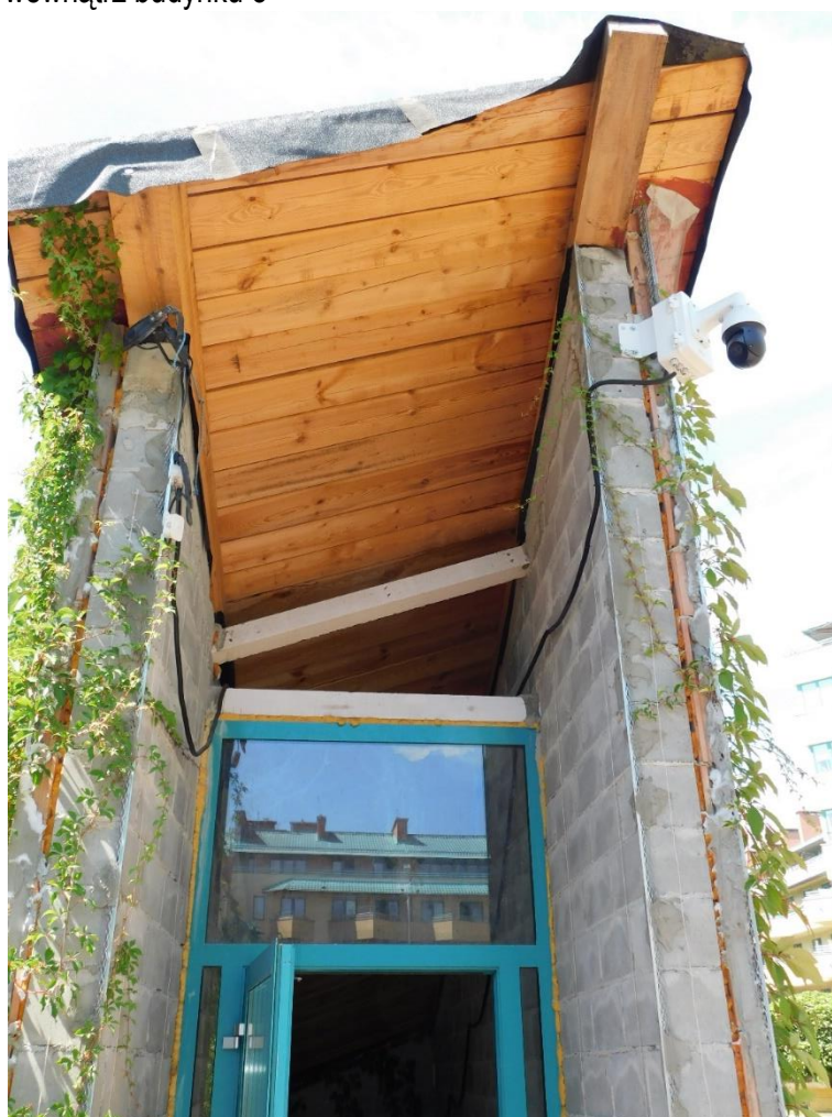
8. Widok konstrukcji dachu, elementy drewniane nie zabezpieczone przeciwpożarowo 1
